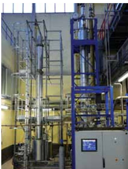
Système de captage en fonctionnement réel (LLT).
